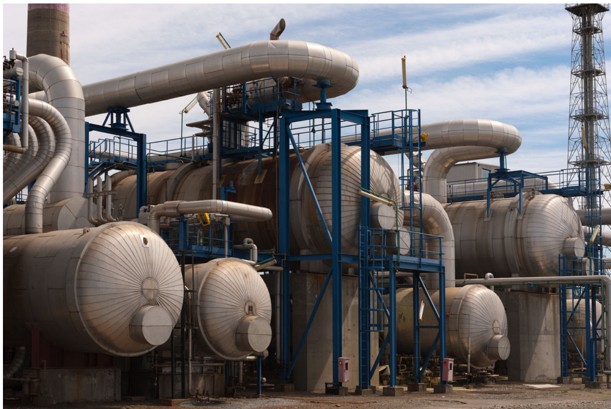
Réacteurs catalytiques pour le traitement du gaz acide
